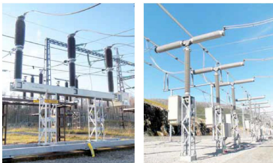
Figura 21 – Disjuntor SF6 145 kV e 420 kV
