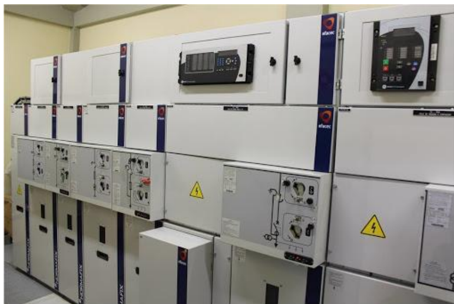
Figura 10 – Celas de média tensão equipadas com CBT's
