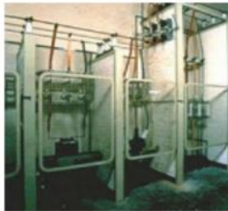
Figura 3 – Celas de média tensão em alvenaria [1]
