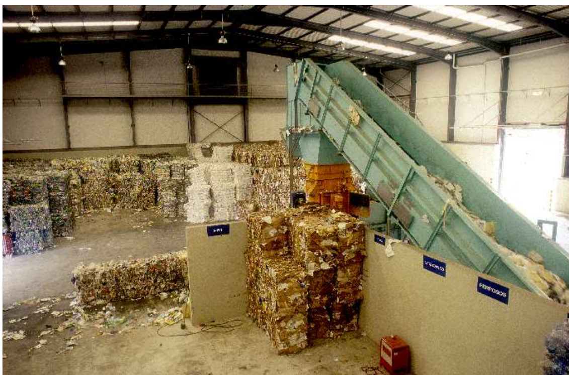
Figura 2-11 - Centro de Triagem - Baguim do Monte [Fonte: LIPOR]
