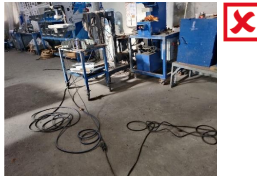
Figura 22 - Cabos de alimentação espalhados no chão
