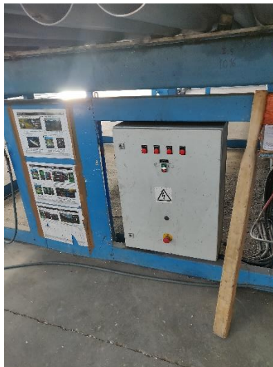
Figura 29 - Inexistência de registos ou programação de manutenções
