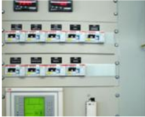
Figura 53 Serviços Auxiliares de tensão contínua [19]
