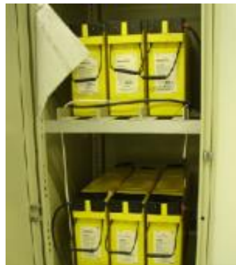
Figura 56 Baterias de corrente contínua [19]
