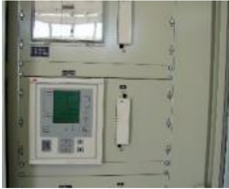
Figura 49 Unidade de Proteção [19]
