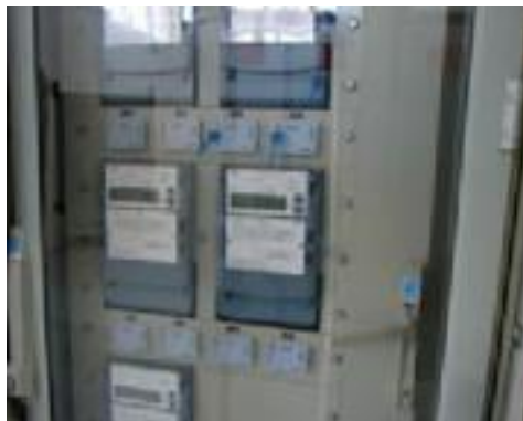
Figura 50 Armário de Contagens [19]
