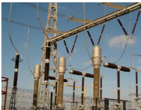
Figura 40 Descarregador de sobretensão por resistência não linear [19]
