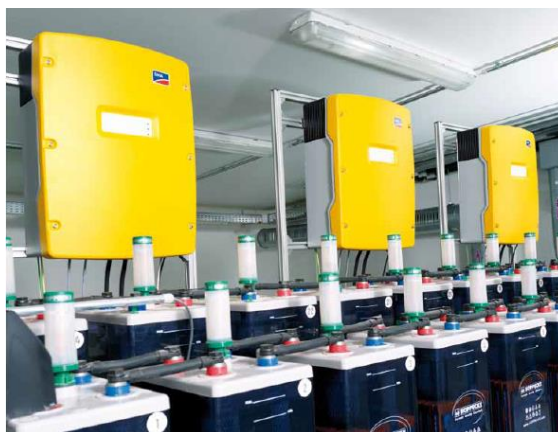
Figura 64 – Inversores Sunny Island 8.0H ligados a um banco de baterias. (Fonte:SMA)
