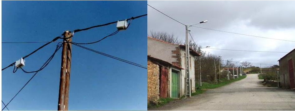
Figura 66 – Rede de distribuição elétrica em baixa tensão (Fonte: EDP Distribuição)
