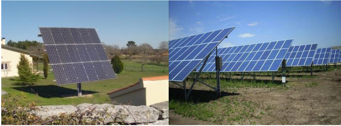
Figura 24 - Painel e gerador FV (respetivamente) (Fonte: http://www.bigsolar.eu/Novidades.html )
