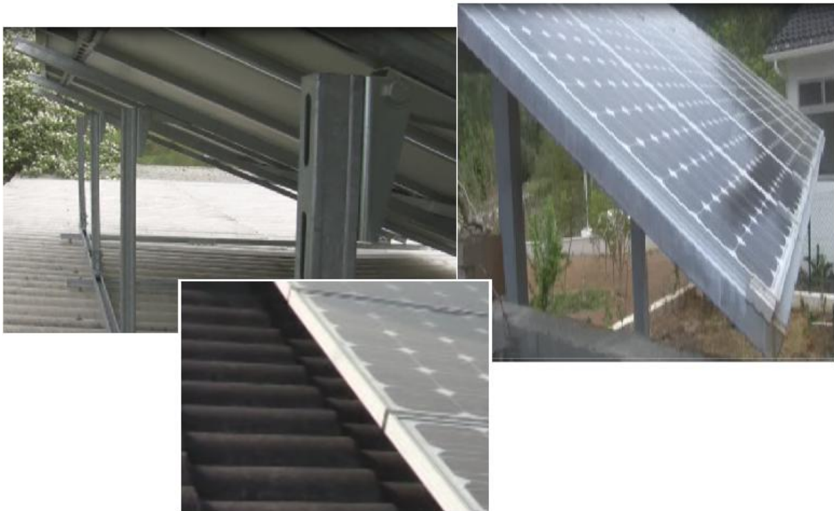
Figura 3.1. Estruturas de apoio dos painéis fotovoltaicos
